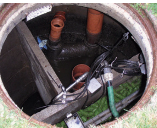
Kleinkläranlage (Foto oben: © S. Auth LfU)
