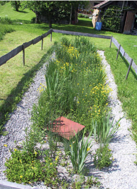
Kleinkläranlagen sind Anlagen zur Reinigung von Abwasser von 4 bis 50 Einwohnerwerten. Sie kommen bei abgelegenen Gebäuden oder kleinen Siedlungen zum Einsatz, wenn eine Abwasserentsorgung durch Anschluss an große, kommunale Kläranlagen nicht möglich ist. (Foto: © S. Weiß WWA Weilheim)
