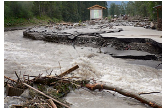
Das Hochwasser der Stillach im Jahr 2005 verursachte große Schäden. (Foto: © WWA Kempten)
